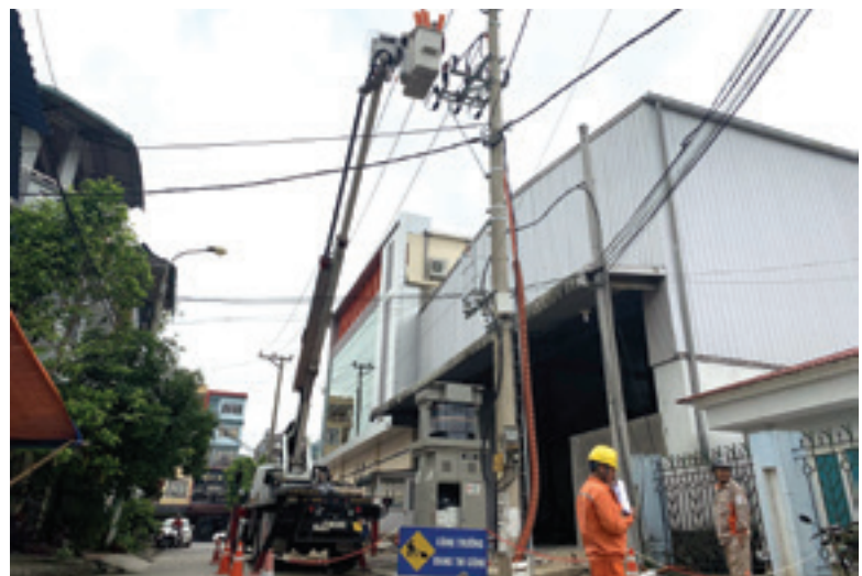
Thi công hotline bằng xe gàu chuyên dụng
